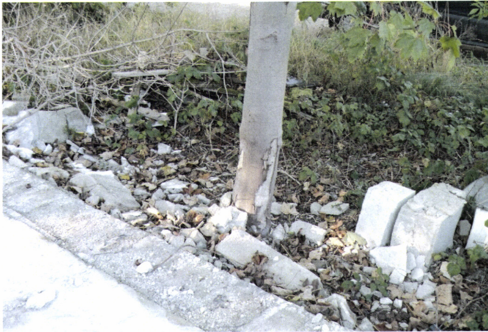
Foto: Einzelbaum aus der Gehölzgruppe in der Nähe der Einfahrt - Bergahorn zwischen Bauschutt mit Rindenschäden.
